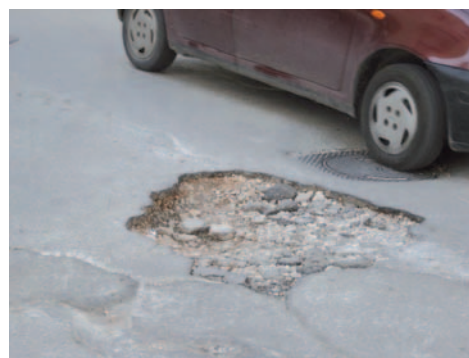
Trani, asfalto dissestato in via Bachelet
